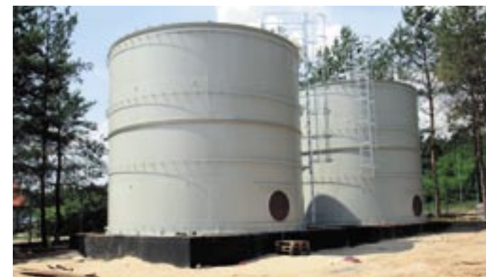
Nowe zbiorniki wody czystej na stacji uzdatniania wody w Wierzbicy
