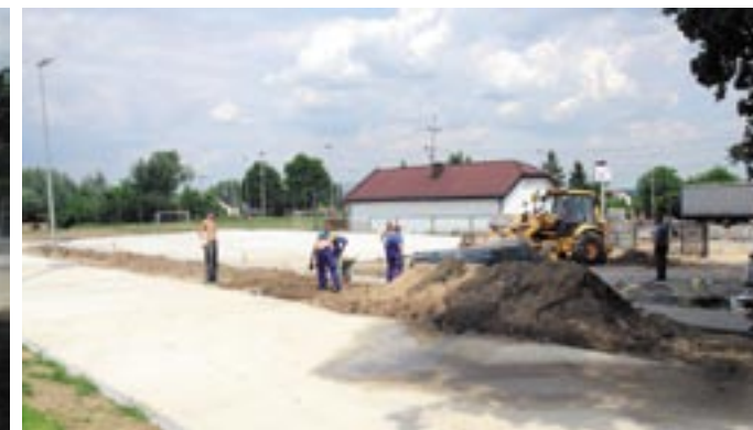
Budowa rozbieżni do skoku w dal w ramach modernizacji stadionu miejskiego w Serocku
